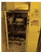
破損した拡散炉。ウエーハに酸化膜を形成する重要な装置
