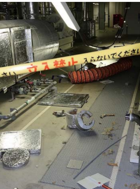
本震で被災した工場内
