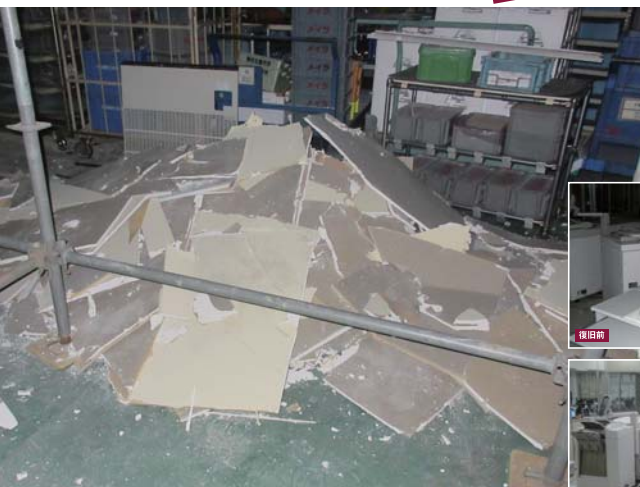
工場では内壁の一部が脱落した
