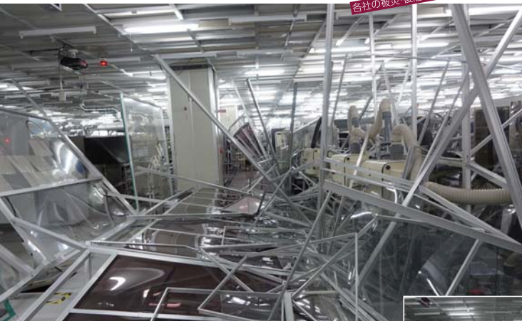
被災したクリーンルーム
