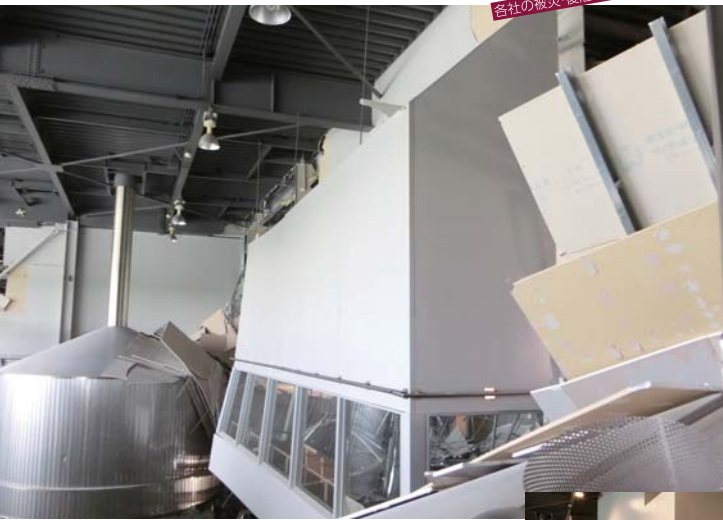
一部壁が崩れ落ちた仕込み室
