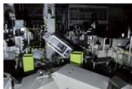
倒壊した梱包機の検査機制御盤
