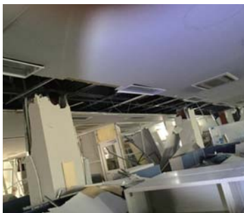
天井が落ち、柱が折れるなど構造躯体に甚大な被害が出た
