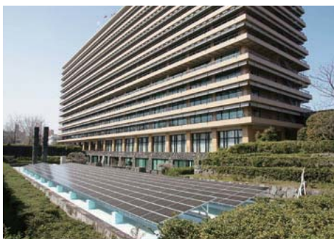
熊本県庁行政棟本館南側 サンクガーデン内に設置された (株)ホンダソルテック製の太陽電池
