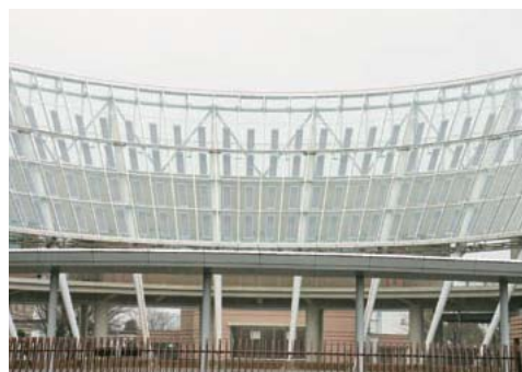
熊本県立技術短期大学校 アカデミックプラザに設置された 富士電機システムズ(株)製の太陽電池
